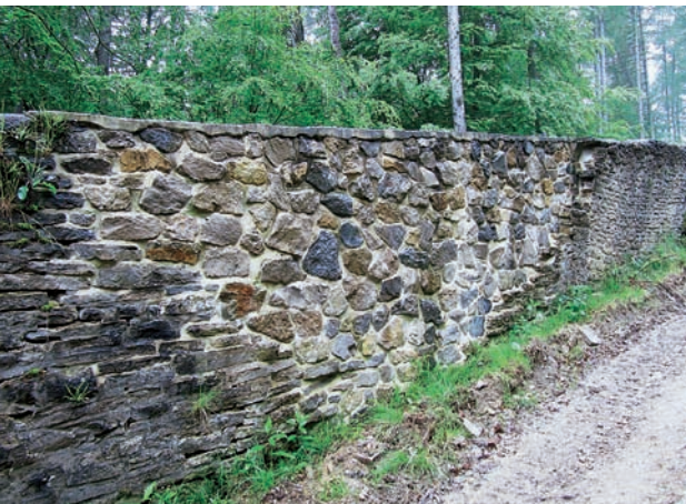
Abb. 7: Nicht jede Mauersanie- rung der letzten Jahre folgte dem Anspruch der Materialtreue. So wurde hier ein Loch in der Mauerpassage aus platti- gem Kalkstein mit unre- gelmäßigen Bruchsteinen verschlossen Foto: Roswitha Kirsch- Stracke (Hannover)
